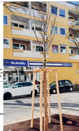
Regenrückhalt in Saarbrücken mittels Baumrigolen.
